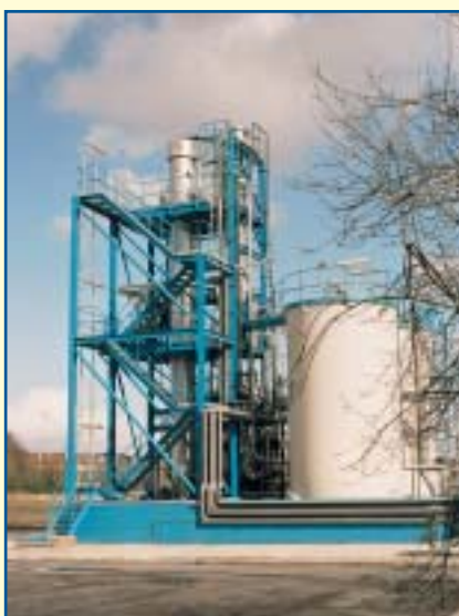
Unité de récupération NH 3 /CO 2 - Royaume Uni. Capacité : 9 tonnes/h.
